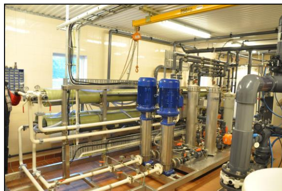
Bild 24: Skärgårdsstiftelsens avsaltningsanläggning på Utö gör dricksvatten av havsvatten. Foto: Martin Ragnar
