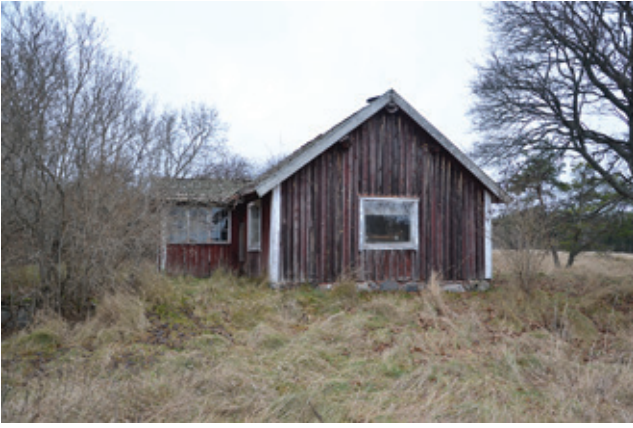
Mälby Norrgård: Det äldre bostadshuset vid Mälby Norrgård är i dåligt skick och har tillägg från flera perioder, bl.a. fönster från mitten av 1900-talet. Foto: Tobias Mårud.
